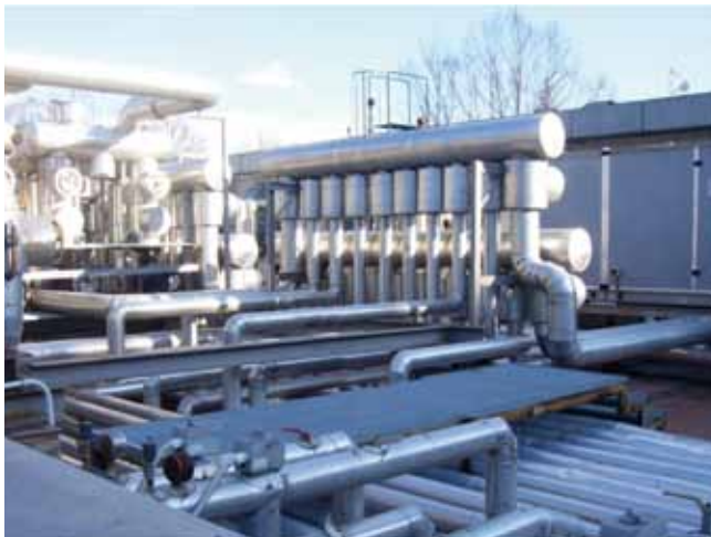
Accessibilità e Manutenibilità: ci vorrebbe un "Puffo" per accedere agli strati impermeabili, sotto gli impianti.
