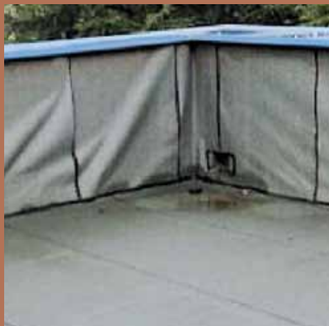
Risolto verticale in membrana in bitume polimero, realizzato su un parapetto costituito da un pannello in Cls. prefabbricati. La causa di questa "patologia" sono le tensioni generate, al piede del risolto, dal movimento del giunto di accostamento tra superficie orizzontale ed elementi perimetrali prefabbricati.
