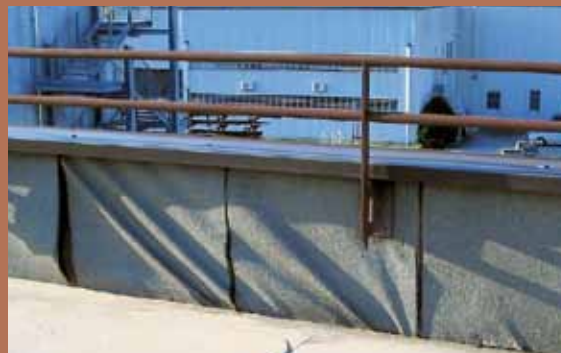
Risolto verticale in membrana in bitume polimero, realizzato in continuo tra superficie corrente e supporto verticale di contenimento, distaccato ed ondulato. La causa di questa "patologia" sono le tensioni generate, al piede del risolto, dalla mancanza di un adeguato strato separatore (es. film di polietilene microforato o cartonghesso bitumato) posto sotto la pavimentazione ed anche alla mancanza di un adeguato elemento comprimibile e separatore (es. polietilene o polistirene espanso) posto, nello spessore della pavimentazione in adiacenza al risolto verticale.
