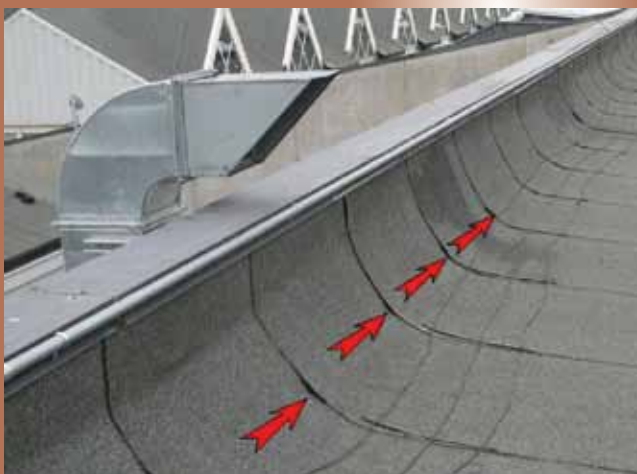
Risvolto verticale di membrana in bitume polimero, risvoltata direttamente dal piano sul verticale. La mancanza di una protezione e fissaggio meccanico sulla parte terminale, ha causato, per il calore estivo, lo scollamento della membrana dal supporto.
