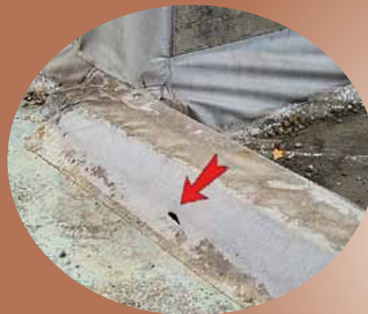
Risolto verticale in membrana di PVC-P, prodotta per "calandratura", realizzato su una trave rovescia, senza fissaggio al piede dei risvolti e con zavorramento (già rimosso) in ghiaia. Le variazioni dimensionali dovute al naturale invecchiamento del prodotto (perdita di plastificante) hanno messo in tensione i risvolti verticali, causandone persino la lacerazione, in alcuni punti.
