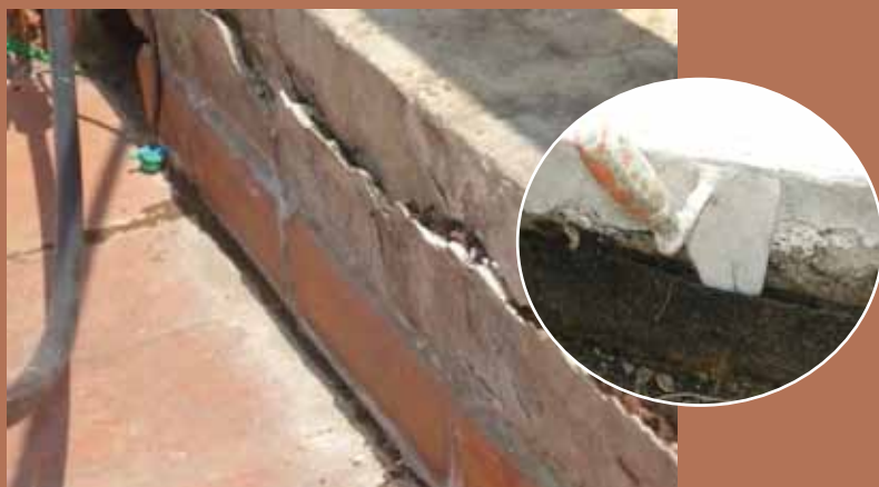
Risolto verticale di membrana in bitume polimero, non correttamente incollato al supporto, che si è aperto staccando anche la protezione in intonaco.
