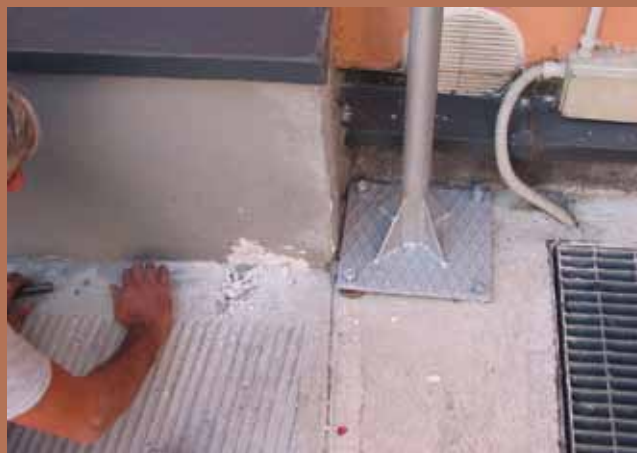
Risvolto verticale di membrana in bitume polimero annegato nello spessore della pavimentazione di rampa. Sulla destra si nota un intervento di demolizione dell'intonaco, per verificare la presenza o meno del risvolto impermeabile.
