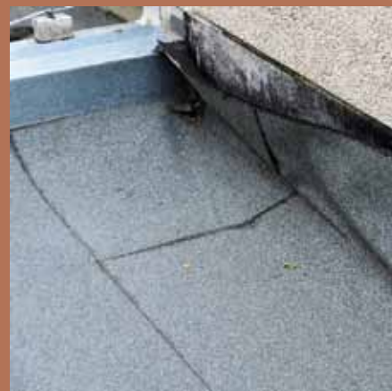
Risolto verticale in membrana in bitume polimero, realizzato su un parapetto monolitico. La membrana è risolta a "ciabatta" troppo larga ed è stata incollata al supporto verticale, senza operare alcun fissaggio meccanico superiore.
