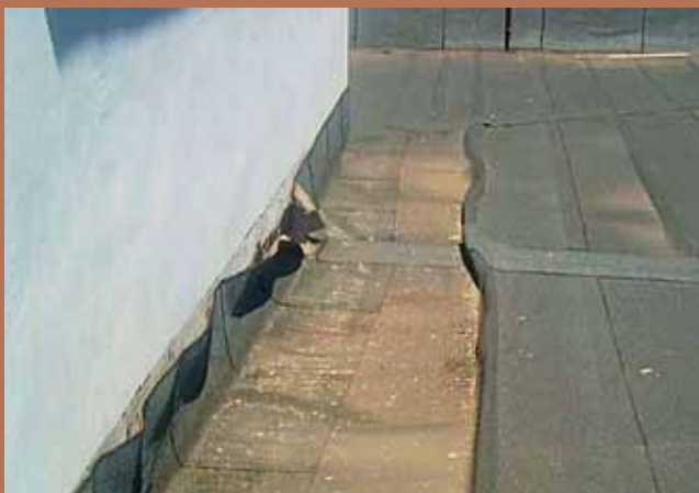
Risvolto verticale di membrana in bitume polimero, risvoltata direttamente dal piano sul verticale. La mancanza di una protezione e fissaggio meccanico sulla parte terminale, ha causato, per il calore estivo, lo scollamento della membrana dal supporto.
