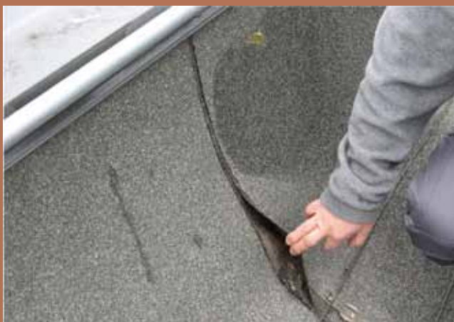
Risvolto verticale in membrana in bitume polimero, realizzato in continuo tra superficie corrente e supporto verticale di contenimento. Si nota l'andamento diagonale del risvolto in tensione, dovuto a ritiro della membrana e la conseguente apertura, delle giunzioni di saldatura al piede del risvolto.
