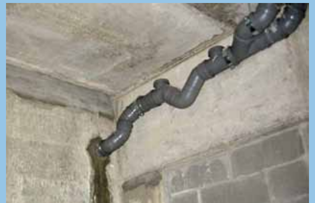
Quando ci si vuole complicare la vita! Collegamento orizzontale di un pluviale di scarico, con uscita a parete. Più di 15 raccordi in meno di 2 metri! Il minimo che può succedere è che si intasi il tubo!
