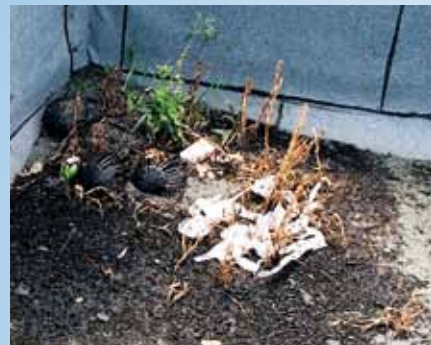
Scarico su una copertura con impermeabilizzazione a vista in membrane in bitume polimero ardesiate. La mancanza di manutenzione periodica ha causato con il tempo l'accumularsi di materiali, trasportati da acqua e vento, in corrispondenza di un angolo della copertura, con conseguente occlusione totale dello scarico qui presente.
