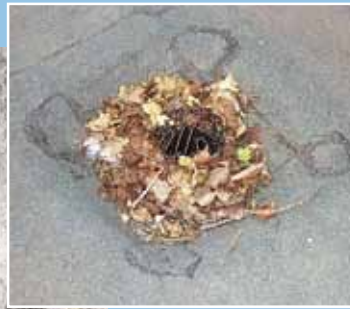
Scarico su una copertura con impermeabilizzazione a vista in membrane in bitume polimero ardesiate. La mancanza di manutenzione periodica ha causato l'occlusione, quasi totale dello scarico, con accumulo di foglie al contorno.
