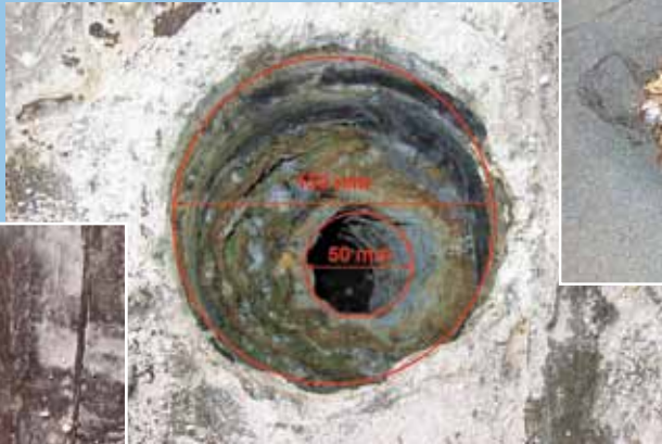
Scarico su una copertura a parcheggio, quasi totalmente occluso da residui calcarei. L'occlusione (90% circa della superficie del foro) è avvenuta in meno di tre anni dalla consegna dell'edificio.
