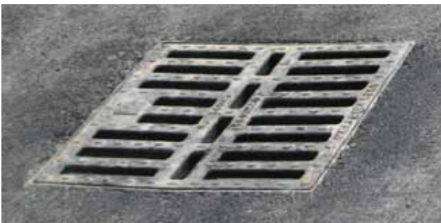
Metodologia corretta di realizzazione di uno scarico, su una copertura con protezione pesante fissa in conglomerato bituminoso. In corrispondenza dello scarico è stato posizionato un pozzetto, con superiore chiusino apribile grigliato.
