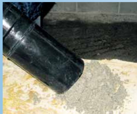
Svuotamento di pluviale chiuso da boiaccia di cemento penetrata durante il getto del massetto in copertura.
