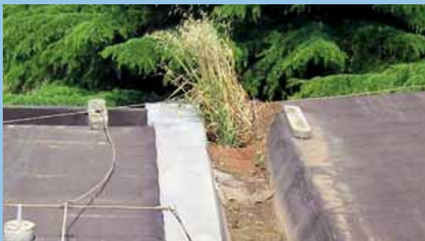
Scarico su una copertura con impermeabilizzazione a vista in membrane in bitume polimero. La mancanza di manutenzione periodica ha causato l'occlusione totale dello scarico, presente nel canale di convesa, in quanto al suo interno sono germogliate piante erbacee.
