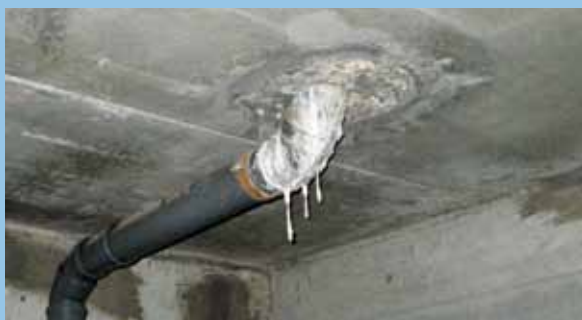
Conseguenze all'intradosso del solaio a causa di uno pluviale occluso.
