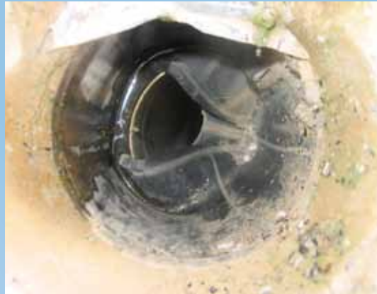
Tronchetto di bocchettone in materiale plastico deformato per inserimento del pluviale eseguito successivamente dall'intradosso del solaio.
