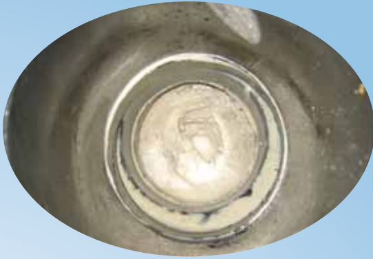
Pluviale chiuso da boiaccia di cemento penetrata durante il getto del massetto di tipo industriale sull'impermeabilizzazione in copertura.
