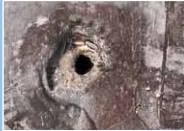
Scarico su una copertura con pavimentazione piastrellata (rimossa), quasi totalmente occluso da residui calcarei.
