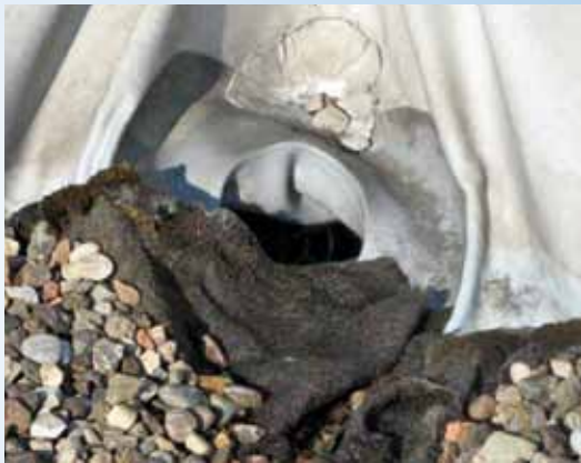
Copertura con zavorramento in ghiaia ed impermeabilizzazione in membrana polimerica in PVC-P. La membrana impermeabile, di tipo calandrato, si è ritirata, lungo i perimetri, sollevando lo scarico dal suo alloggiamento. Quando scaricherà questa copertura? Visto che il foro dello scarico è sollevato di circa 5 cm rispetto alla superficie adiacente.
