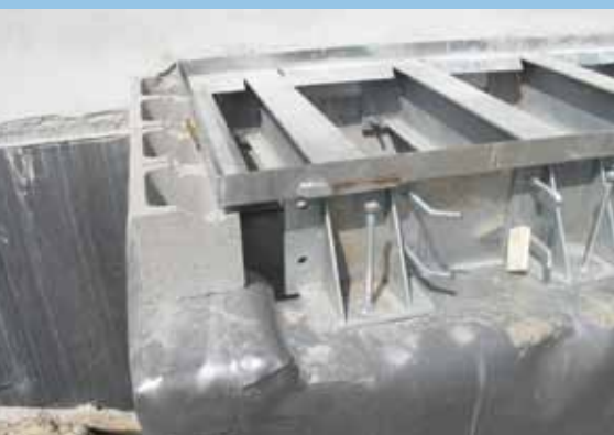
Grigliato fissato, in modo errato, direttamente sulla testata del basamento, forando l'impermeabilizzazione già posata. L'unica possibilità di collegamento e ripresa dell'elemento di tenuta resta l'incollaggio delle membrane sull'aletta verticale del telaio, dopo aver creato una guscia di raccordo in malta.
