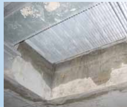
Conseguenze della posa scorretta del grigliato, senza scossalina di gocciolatoio e con risvolto ed incollaggio dell'impermeabilizzazione direttamente sull'aletta verticale del telaio.
