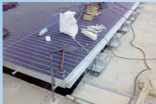
Grigliato fissato, in modo errato, direttamente sul solaio, prima della posa dell'impermeabilizzazione. L'unica possibilità di collegamento e ripresa dell'elemento di tenuta resta l'incollaggio delle membrane sull'aletta verticale del telaio, dopo aver creato una guscia di raccordo in malta.
