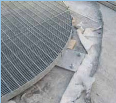
Grigliato fissato, in modo errato, direttamente sullo strato impermeabile orizzontale già in opera, forandolo. L'unica possibilità di collegamento e ripresa dell'elemento di tenuta resta l'incollaggio delle membrane sull'aletta verticale del telaio.
