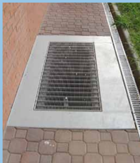
Corretta metodologia di posa di grigliato, con telaio/scossalina di protezione sagomato a "C". Vista di grigliato in opera, realizzato con telaio/scossalina di protezione, posizionato sulla testata del basamento, realizzato con lamiera zincata ad alto spessore, sagomata a "C".
