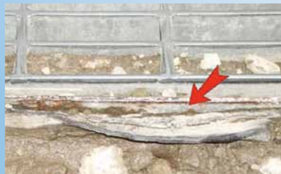
Distacco della membrana incollata direttamente sull'aletta verticale del telaio, dopo solo due cicli stagionali, visto dopo la demolizione della pavimentazione.
