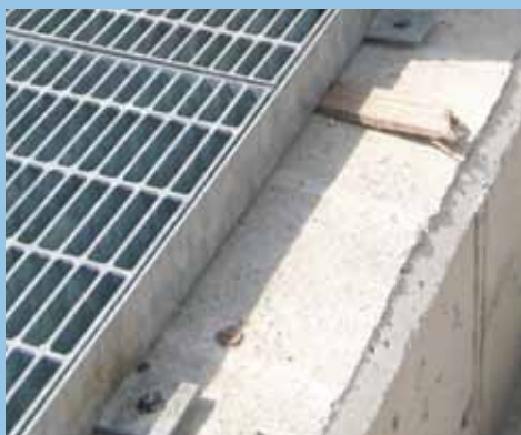
Grigliato fissato, in modo errato, direttamente sulla testata del basamento, prima della posa dell'impermeabilizzazione. L'unica possibilità di collegamento dell'elemento di tenuta resta l'incollaggio delle membrane sull'aletta verticale del telaio.
