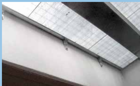
Corretta metodologia di posa di grigliato carrabile, con telaio/scossalina di protezione sagomato a "C". Vista delle staffe di fissaggio perimetrali interne al foro del grigliato.
