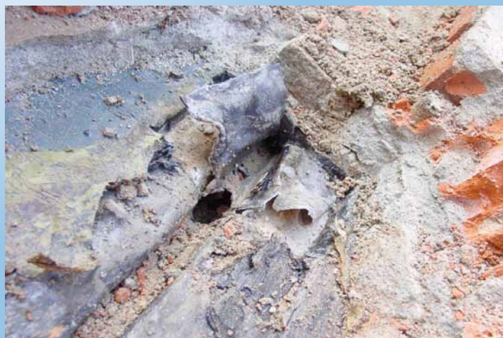
Ci si è ricordati di posizionare il giunto impermeabile, ma peccato che ci si è dimenticati del giunto meccanico a pavimento. Il risultato è stato che il giunto con soffietto in piombo, posato comunque scorrettamente, per le tensioni ingenerate, si è deformato e staccato sulla testata di collegamento delle lastre di piombo.
