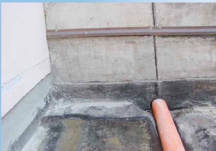
Come si colgono "due piccioni con una fava"? Cosa c'è di più assurdo che utilizzare il soffietto negativo di giunto, per alloggiare (al posto dell'elemento comprimibile) un pluviale orizzontale che collega ovviamente uno scarico posto in corrispondenza del giunto stesso!??
