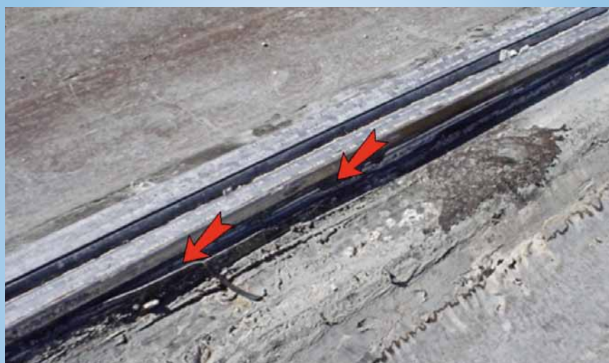
Danneggiamento (con taglio) della cimosa di collegamento in gomma sintetica, per bruciatura durante la fase d'incollaggio a fiamma della membrana impermeabile in bitume polimero.
