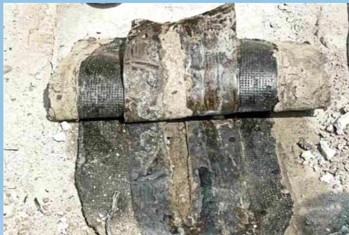
Delaminazione, per errore d'applicazione, tra i vari strati costituenti un giunto a doppio soffietto con interposizione di "omega" in lastra di piombo.
