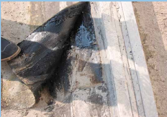
Distacco, per non corretta adesione, della membrana impermeabile in bitume polimero dalla cimosa di collegamento di un giunto prefabbricato integrato.
