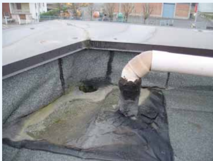
PASSAGGIO DI TUBAZIONI ATTRAVERSO L'IMPERMEABILIZZAZIONE E IL SOLAIO, OLTRETUTTO BLOCCANDO IL DEFLUSSO DELLE ACQUE VERSO LO SCARICO
