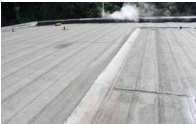
Imbarco dei pannelli termoisolanti e fessurazione dello strato impermeabile, causato da movimenti presenti sulla linea di accostamento di testa tra elementi prefabbricati cementizi
