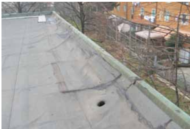
Effetti del tensionamento presente sui risvolti verticali di un elemento di tenuta, fatto risvoltare direttamente sul pannello di tamponamento perimetrale, su una copertura con supporto strutturale in elementi prefabbricati cementizi, senza realizzazione di un adeguato giunto di movimento (scossalina ad L)
