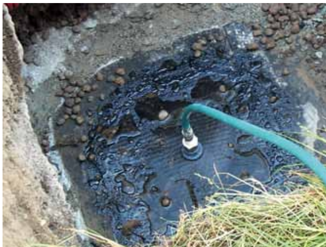
Valvola d'immissione gas, collegata all'intradosso dello strato impermeabile.
