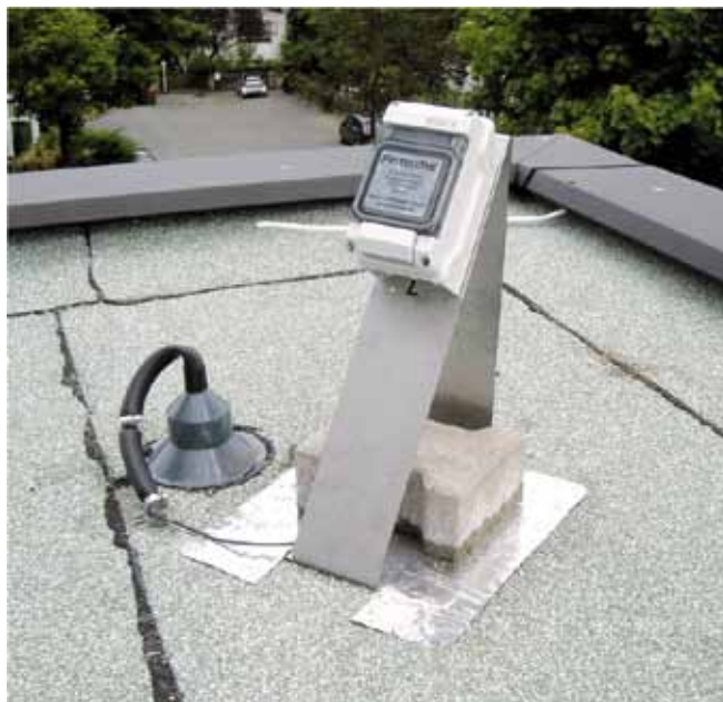
Sistema di rilevamento "PROTECTSYS@ B" - scatola di connessione, posta in copertura, connettabile, in fase di ricerca, al "generatore d'impulsi".
