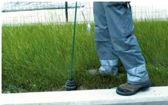
Rilevamento fughe di gas da difettosità dello strato impermeabile.
